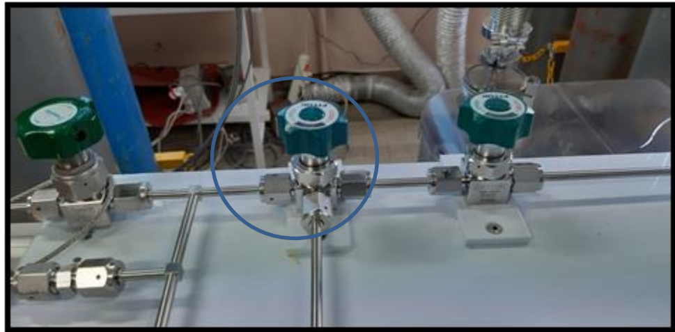
Figure 5 : Vanne 3 voies défectueuses
