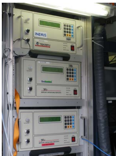
Figure 11 : Vue partielle des analyseurs installés dans le camion laboratoire
