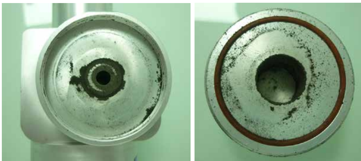
Figure 5 : exemple de ligne de prélèvement (impacteur) avant maintenance
