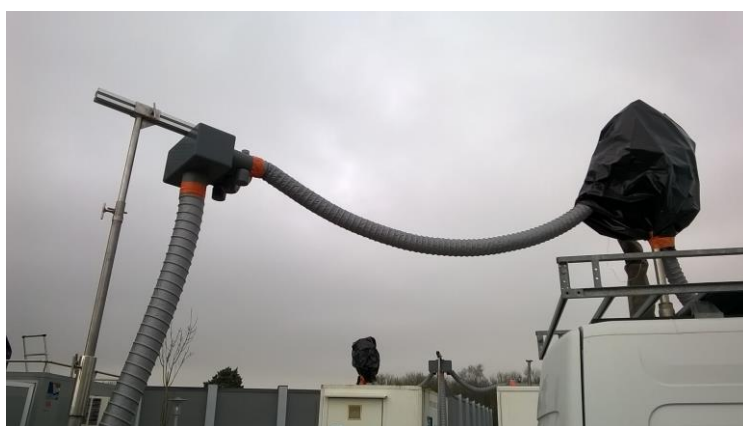
Figure 31 : Vue d'un moyen mobile alimenté en gaz au niveau des têtes de prélèvements
