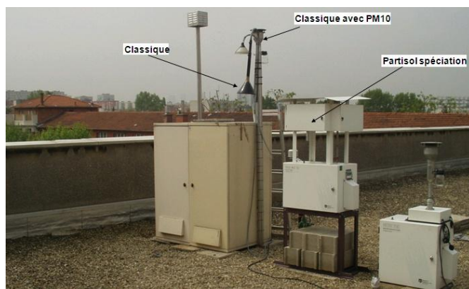
Figure 30 : Prélèvementeurs utilisés par AIRPARIF sur le site de Gennevilliers
